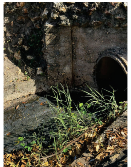
A Prainha, que já teve grande potencial, hoje é só mais um esgoto a céu aberto
